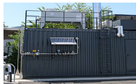
Le moteur de cogénération
